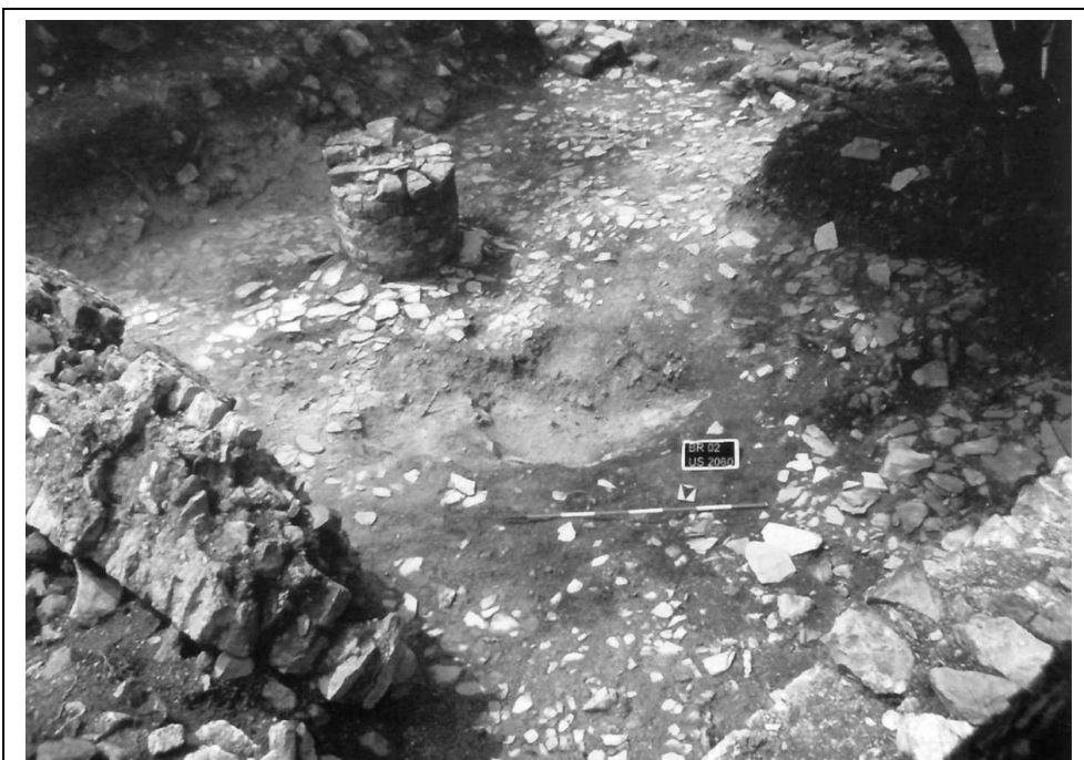
Crollo del tetto in lastre di scisto (Baldassarri,2004,p.110)
